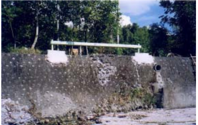
圖一、架設在池上斷層地表破裂帶之「潛變儀」，紀錄每日斷層之變位，精度可達 0.01 公釐。
